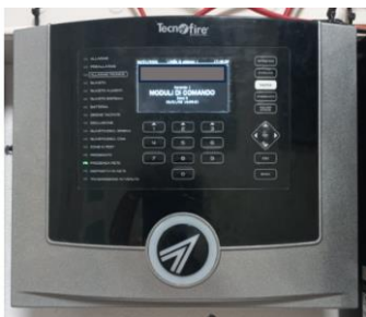
"TECNOFIRE" Aula didattica piano -2 (vano tecnico retrostante le cattedre)
